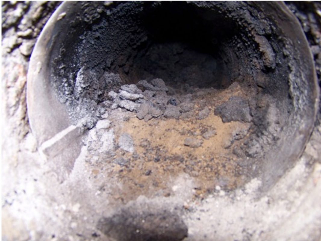
Fotografie č. 5 – ilustrační foto, napojení kotle VIADRUS v kotelně
